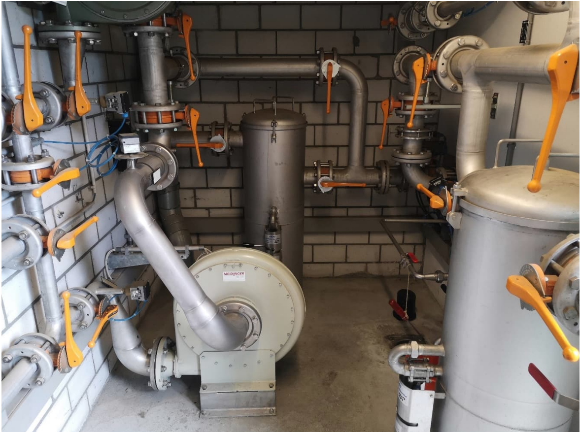
Abbildung 7: Heutiger Gasraum mit Installationen
