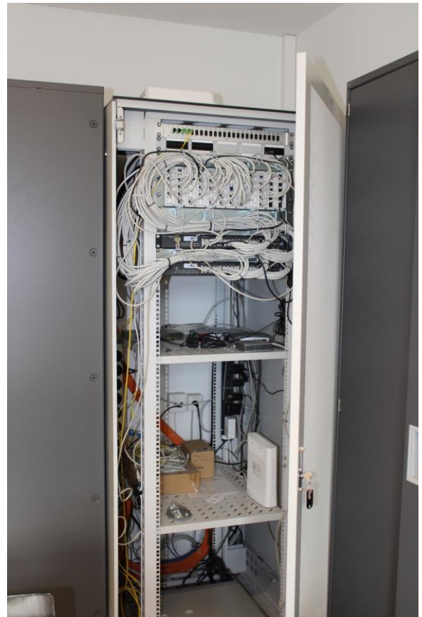
Bild 7: Serverschrank im Raum 207 - "Drucker/Material"
